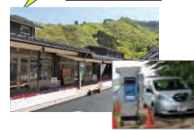
EV車等への給電設備
