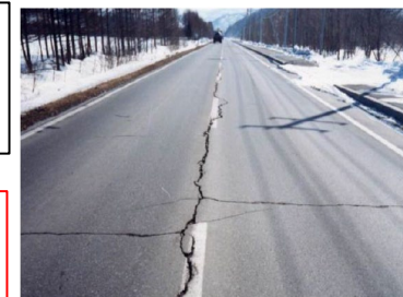
凍上災害による舗装の損傷事例
