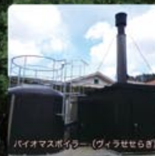
木質バイオマス発電
