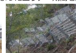
なだれ防止施設
