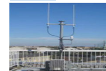
通信施設の整備
